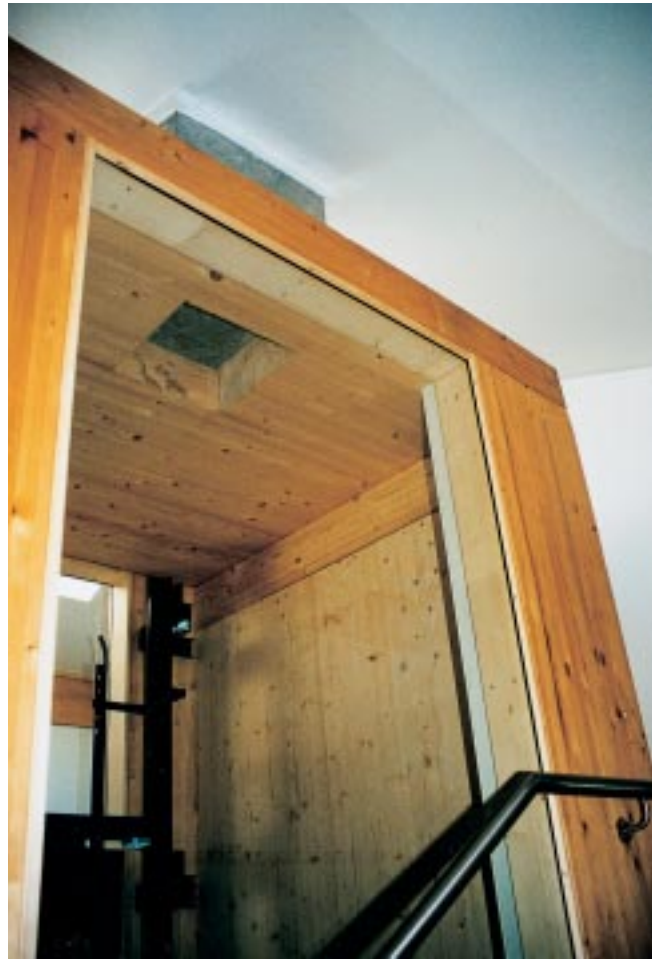
Foto oben: Detailaufnahme des Schachtkopfes mit Entlüftung
